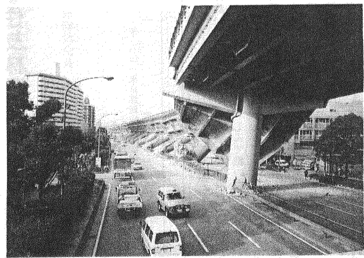
倒壊した阪神高速(東灘区深江本町で。1月17日午前9時半撮影 ニュースネット)
